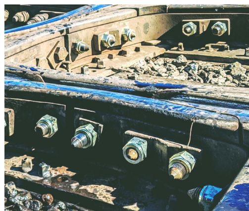
THU installé sur un diamond Class 1
